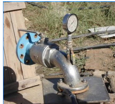
Manomètres en Algérie pour une usine de fabrication de verre
