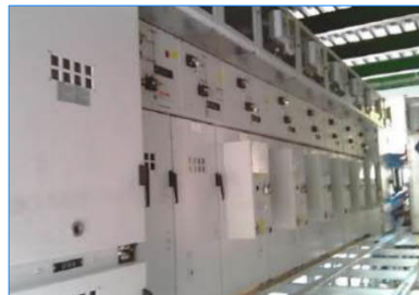
Moyenne Tension : Cellules ABB sur faux plancher - Bahrein
