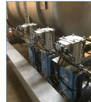
Distribution pneumatique méthanisation
