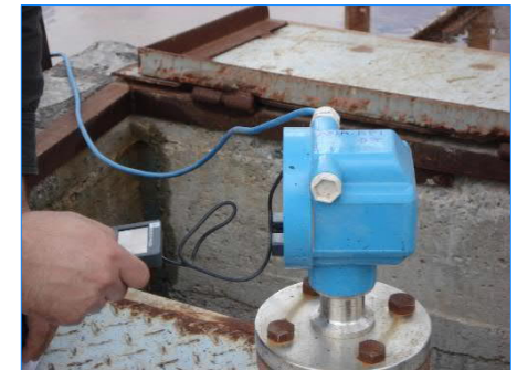
Niveau radar en Algérie pour une sucrerie
